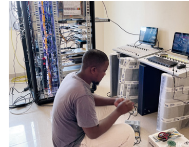
Der Technikraum in Kinshasa wird eingerichtet.
